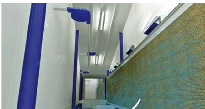
Entrées d'air inférieures.
